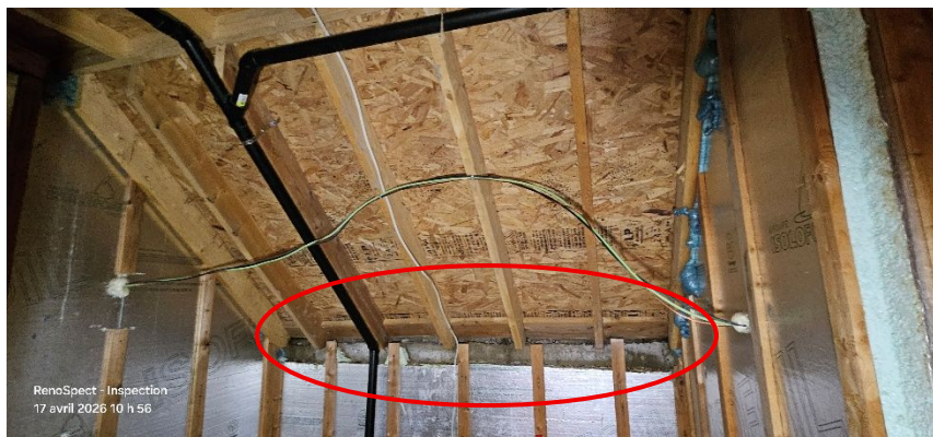
Chambre froide – Signes d’infiltration Sous-sol (avant)
