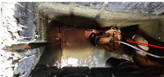
Puisard et pompe – Drain français Sans anomalie importante Chambre froide
