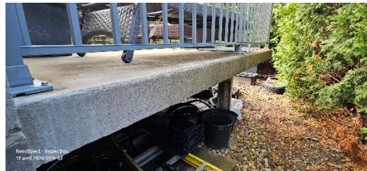
Terrassements et aménagements Installation incomplète Cour arrière
