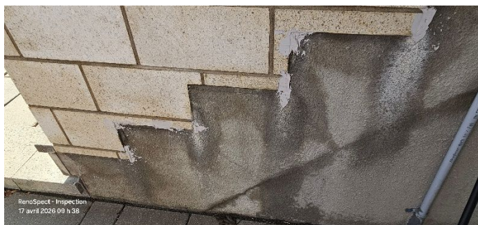
Balcon d'entrée - Infiltration Escalier avant
