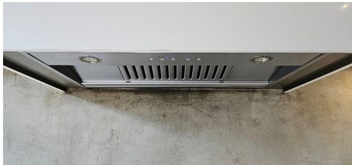
Hotte de cuisinière Sans anomalie importante 1 er étage
