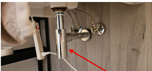
Conduits d'évacuation A surveiller (Blocages fréquents) Lavabo
