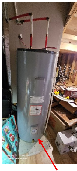
Système de chauffe-eau Raccord inadéquat au drain de plancher (Chambre mécanique)
