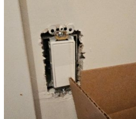
Interrupteur - Plaque manquante Sous-sol
