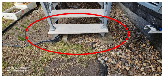
Escaliers extérieurs (2) Ancrage inadéquat Balcon arrière
