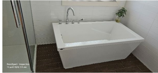
Appareils et robinets Scellant absent ou détérioré Baignoire
