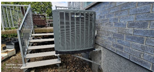
Appareils de climatisation / thermopompe (1) Sans anomalie importante Façade arrière
