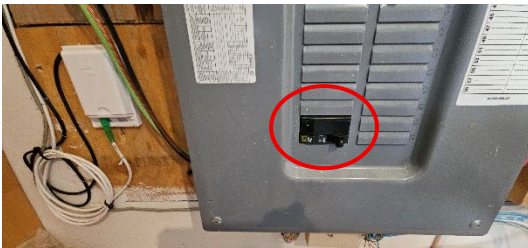
Borne de recharge Sans aucune anomalie Disjoncteur 60A / 240 Volts
