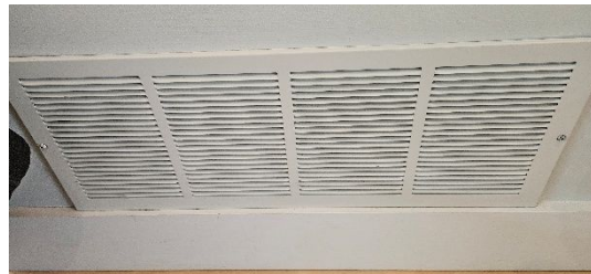
Appareils de chauffage -Registre Entrée - 1 er étage
