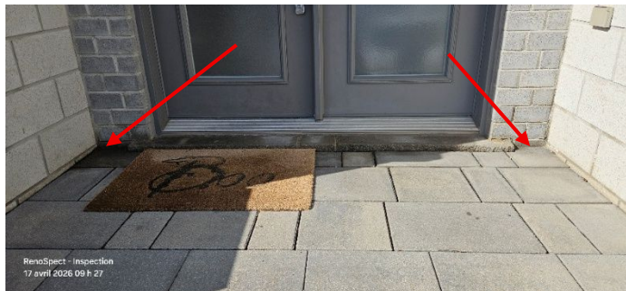
Balcon d'entrée - Accumulation / infiltration d'eau Façade avant
