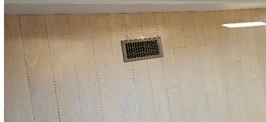
Appareils de chauffage -Registre Sortie -1 er étage
