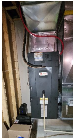
Appareils de chauffage -Central Sous-sol
