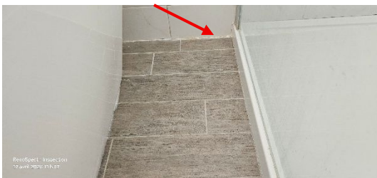
Appareils et robinets – Infiltration (1) Douche
