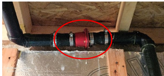
Clapet anti-retour Sans anomalie importante Chambre froide
