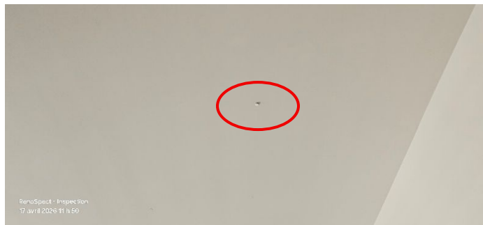
Revêtement de finition des plafonds Dommages observés Salle de bain
