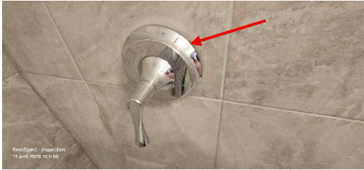
Appareils et robinets Scellant absent ou détérioré Douche
