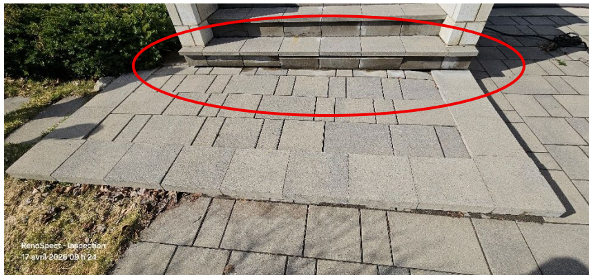
Trottoir d'entrée Affaissement observé Façade avant
