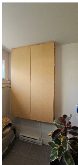
Panneau de distribution (1) Sans anomalie importante Sous-sol
