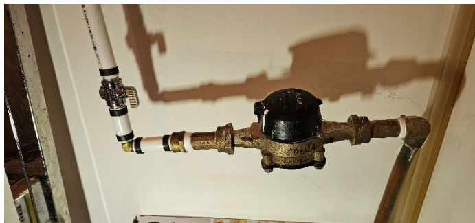
Entrée principale Compteur d'eau Sous-sol
