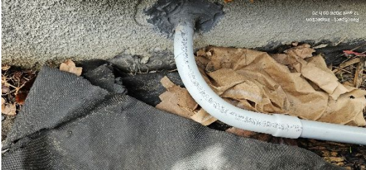
Borne de recharge Sans aucune anomalie Conduit d'alimentation
