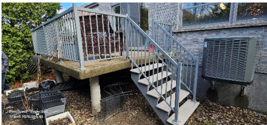
Escaliers extérieurs (1) Ancrage inadéquat Balcon arrière
