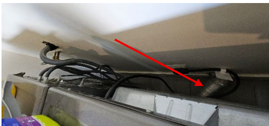
Conduit de sècheuse - Aluminium Sans anomalie importante Sous-sol
