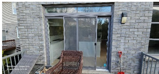
Porte patio Sans anomalie importante Façade arrière
