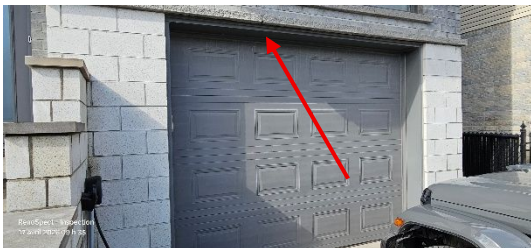
Linteau en maçonnerie Dommages observés (1) Porte de garage
