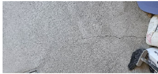
Dalle de béton Fissures observées Garage
