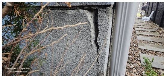
Fondations Fissure Observée (+3mm / 1/8 pouce) Coin arrière gauche
