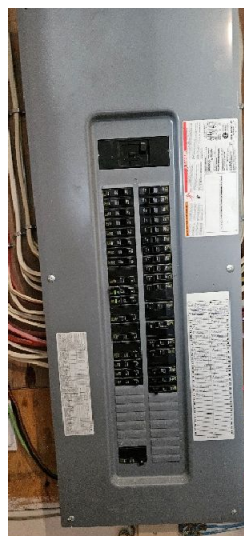
Panneau de distribution (2) Sans anomalie importante Sous-sol
