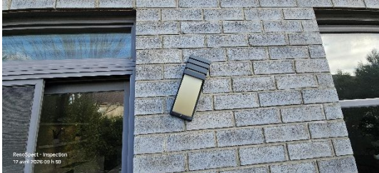
Luminaire - Fixation inadéquate Façade arrière
