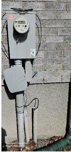
Entrée électrique principale - Souterraine Côté gauche (avant)
