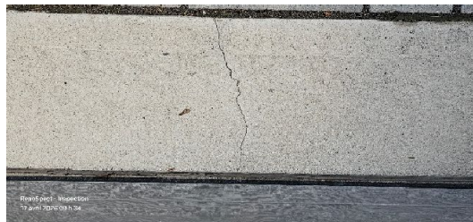
Linteau en maçonnerie Dommages observés (2) Porte de garage
