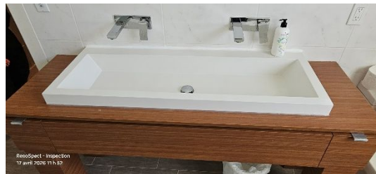
Appareils et robinets Scellant absent ou détérioré Lavabo
